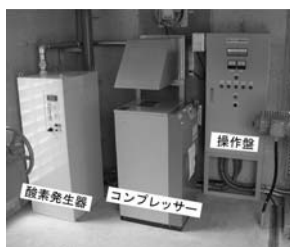
写真-2 地上機器（ゲートハウス内）
