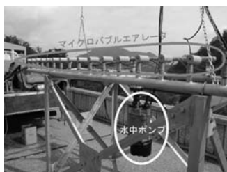
写真-1 エアレータ
