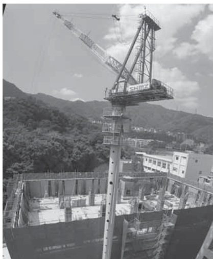
図2 工作技術センター跡地に建設中の先端膜工学研究拠点（平成26年7月1日現在）
