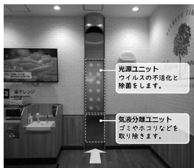
図5：イオンスタイル海老江イートインコーナーに設置されたウイルスフリー空調システム。
